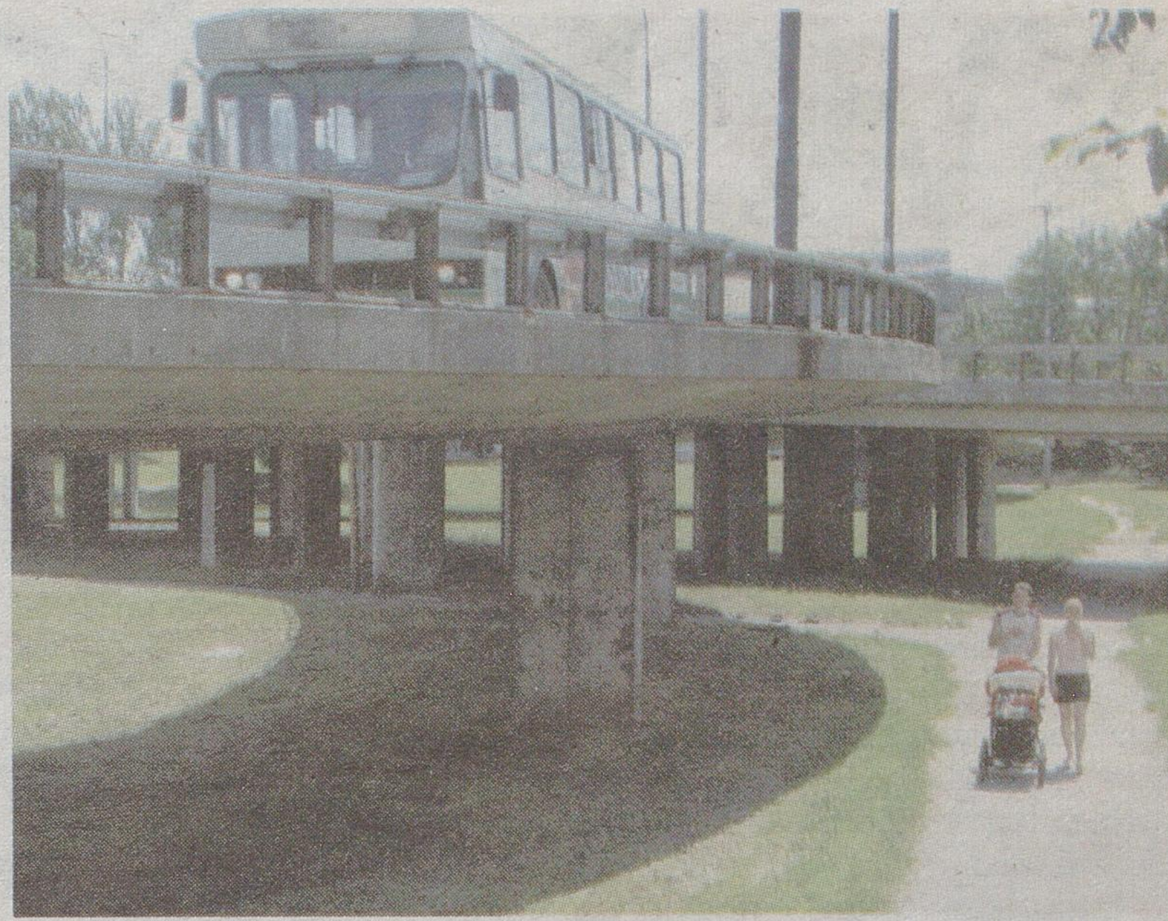
Estakadę trzeba wyremontować, ponieważ jej konstrukcja jest mocno zniszczona
