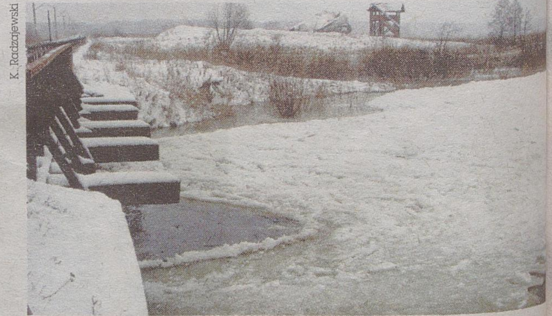
Zwwały lodu napierają na konstrukcję mostu kolejowego, rzeka zalewa niżej położoną drogę
