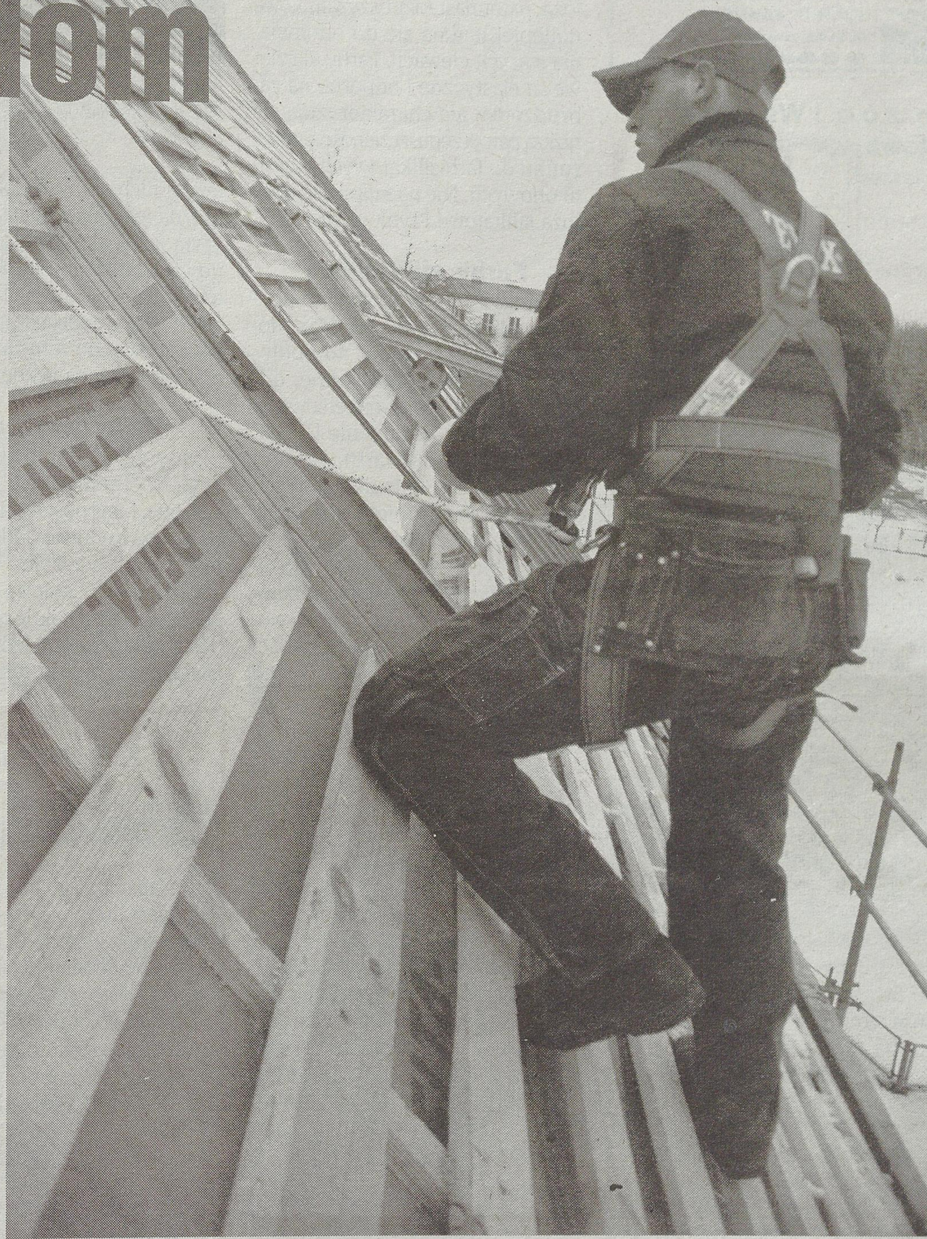
Serwis techniczny firmy Velux zamontował w połaci dachu 43 okna. Na inwestycji wykorzystano okna obrotowe GZL, GGL oraz okna uchylno-obrotowe o podwójnym systemie otwierania GPL.
