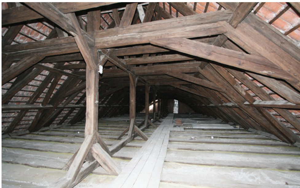
2. Widok ogólny więźby dachu nad nawą główną katedry w Łomży. Fot. M. Warchoł General view of the roof trusses over the nave of the cathedral in Łomża. Photo by M. Warchoł
