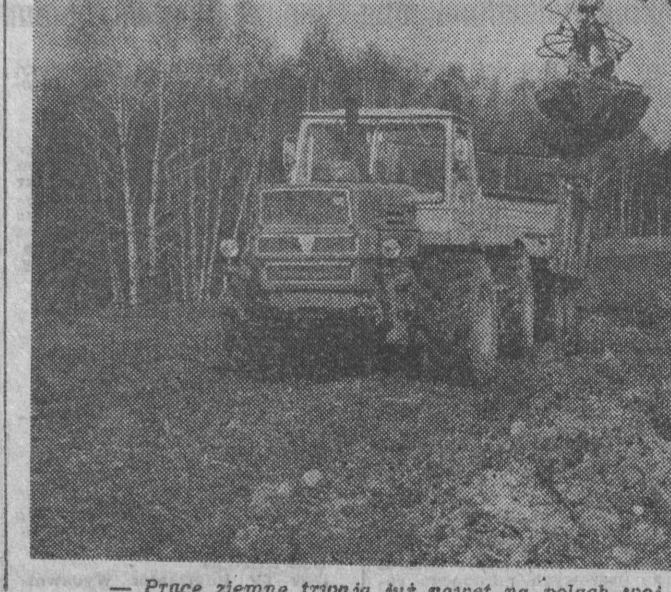
— Prace ziemne trwają już nawet na polach woj. północnych. NA ZDJĘCIU: roboty melioracyjne w PGR Olecko. Fot. Architektura
