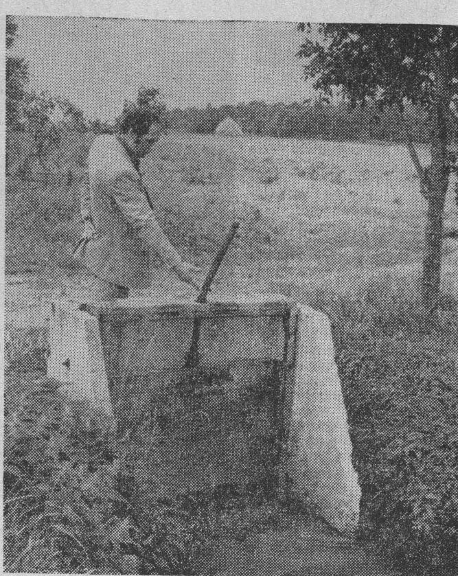
Ta zastawka piętrząca wodę jest uszkodzona i trzeba ją wymienić. Zdzisław Maślanka wskazuje na wykryty w rowie melioracyjnym. Fot. Gabor Lorinczy
