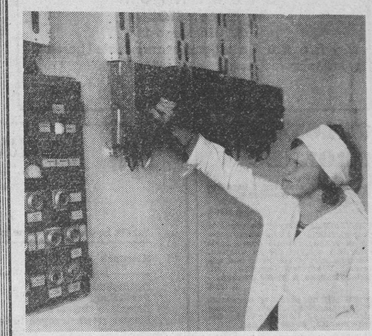
Hodowla brojlerów nie wymaga większej ingerencji człowieka. Praca tu przyjemna... NA ZDJĘCIU: Walentyna Misiejuk przy tablicy rozdzielczej sprawdza stan wentylacji i oświetlenia brojlerni.
