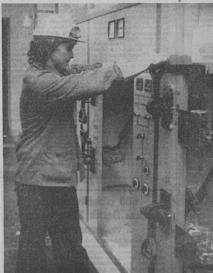
Andrzej Werpachowski, dyżurny technik dokonuje przełączeń na napięciu 15 kV.
