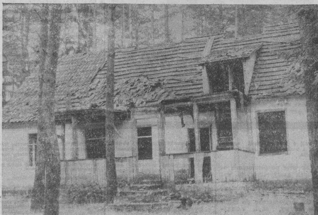
Zdewastowany domek mieszkalny.
