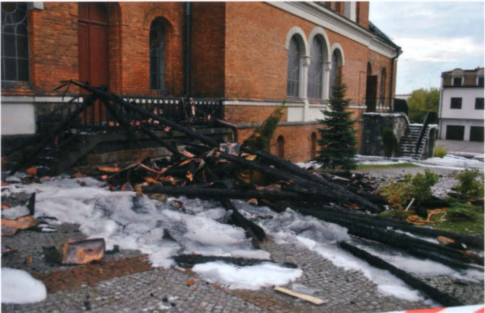
13. Teren przykościelny po akcji gaśniczej, widok od płn.-wsch. Fot. I. Górską, 15.09.2013 r., NID OT Białystok. Area around the church after the fire was put down, view from the north-east. Photo: I. Górską, 15 September 2013, NID OT Białystok.
