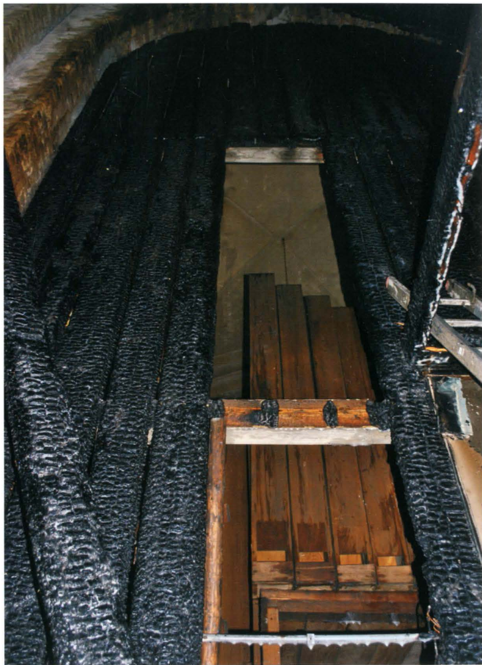
10. Wnętrze wieży, spalona ściana oddzielająca chór muzyczny.
