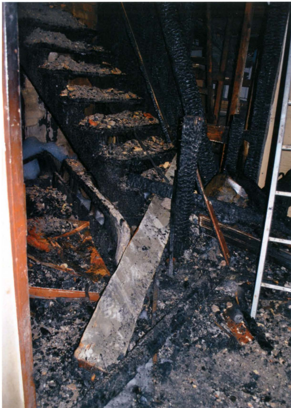
11. Wnętrze wieży, gruzowisko przy schodach na chór. Fot. I. Górską, 15.09.2013 r., NID OT Białystok. Interior of the tower, rubble next to stairs leading to the choir. Photo: I. Górską, 15 September 2013, NID OT Białystok.
