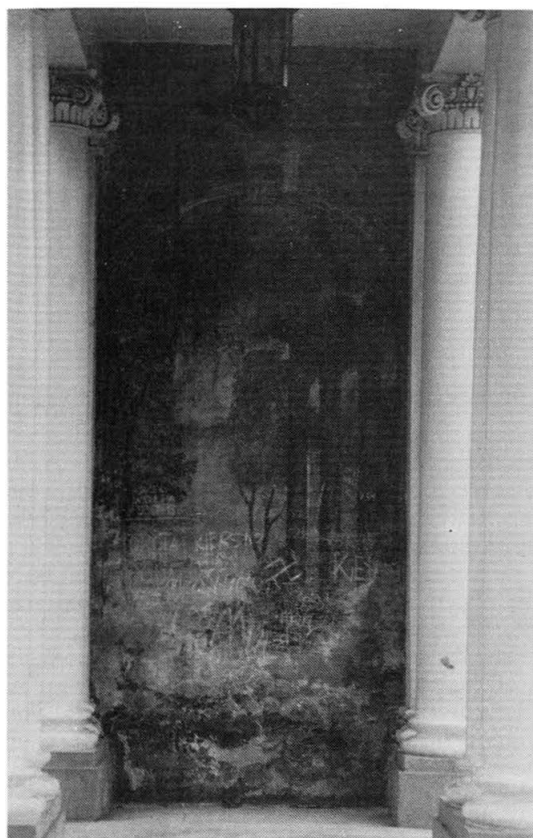
1. Białystok — pałac Branickich. „Pejzaż romantyczny” — malowidło na zewnętrznej ścianie północnej oficyny pałacu, stan przed konserwacją. Fot. Krzysztof Miller, 1993
