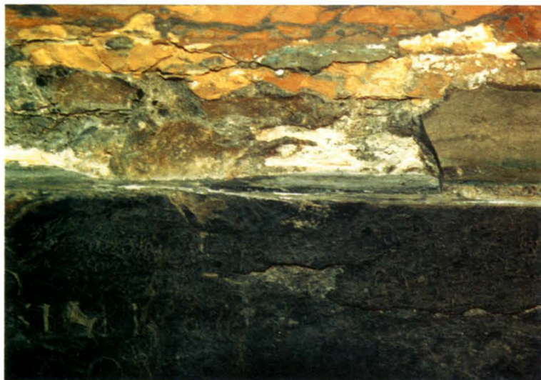
4. Nagrobek J. K. Branickiego - fragment cokołu i tablicy inskrypcyjnej z widocznym rozwarstwieniem żółtego i czarnego marmuru, stan przed konserwacją.
