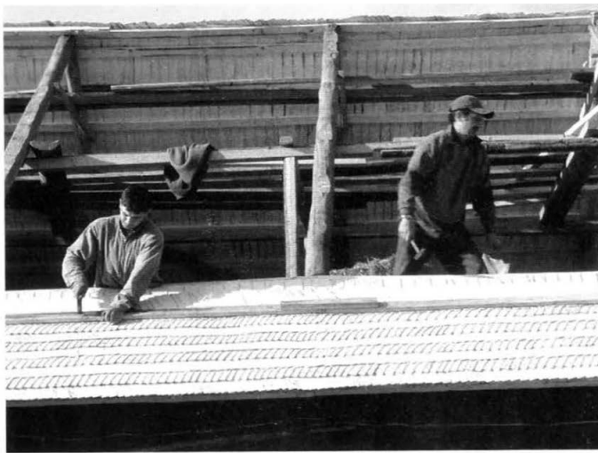
2. Prace przy wymianie dachu w Rosochatym Rogu, sierpień 2000. Changing a roof in Rosochaty Róg, August 2000.
