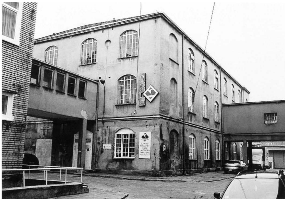
24. Elewacja północno- i południowo-zachodnia dawnej tkalni z widocznymi łącznikami i obniżonym płaskim dachem. Fot. S. Wicher, XI 2010 r. North- and south-western elevation of the former weaving mill with visible connectors and lowered flat roof. Photo: S. Wicher, November 2010.
