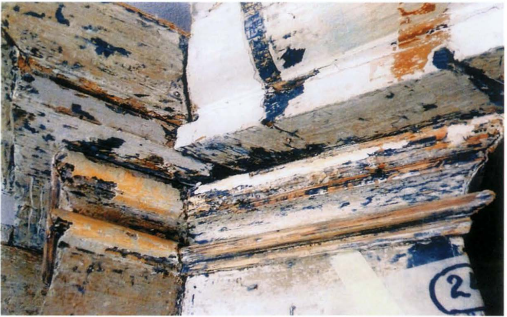
9. Fragmenty górnego gzymsu obudowy piszczałek szafy organowej. Stan w trakcie usuwania przemalowań. Fragments of the upper cornice of the organ pipes case. State in the course of the removal of repainting.
