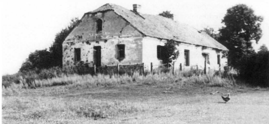
6. Siderka, widok na oficynę lewą. Fot. A. Czapska, 1973 r. Siderka, view of left outbuilding. Photo: A. Czapska 1973
