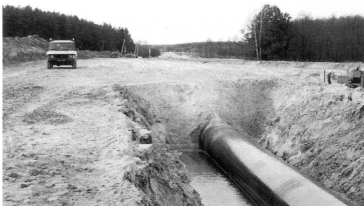
1. Budowa gazociągu w okolicy wsi Leonowicze, gm. Michałowo. Fot. D. Krasnodębski, 1998 r. Construction of gas piping in the village of Leonowicze, commune of Michałowo. Photo: D. Krasnodębski 1998
