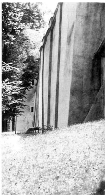
11. Wschodni mur oporowy, widoczne wybrzuszenie w środkowej partii muru. Fot. M. Ambrosiewicz, 1999 r. Eastern resistance wall, visible bulge in the central part of the wall. Photo: M. Ambrosiewicz 1999
