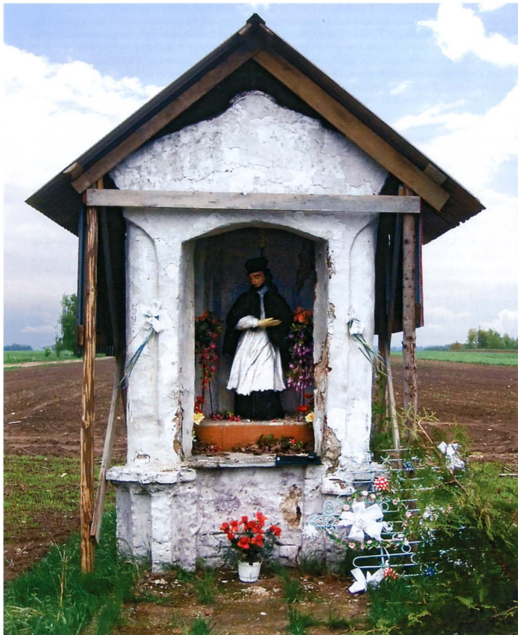
1. Figura św. Jana Nepomucena w kapliczce przydrożnej w Mierzynówce, w trakcie przygotowań do konserwacji.
