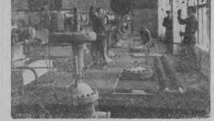
NA ZDJĘCIU: fragment montowania urządzeń przepompowni na trasie rurociągu do NRD. Przepompownia będzie zdalnie sterowana. Proces tłoczenia ropy odbywać się będzie automatycznie. CAF — fot. Czarnogórski
