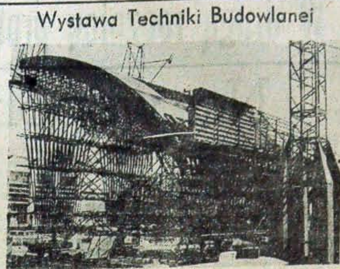
Otwarta w Warszawie wystawa Techniki Budowlanej obrazuje nasz dorobek na odcinku budownictwa mieszkaniowego i przemysłowego. Na zdjęciu: Wielki kombajn rurowy, służący do budowy sklepów hal fabrycznych. Kombajn ten został wybudowany przez polskich fachowców z Gliwic na podstawie wzorów radzieckich.
