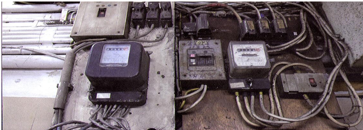
Ryc. 3. Liczniki i instalacja elektryczna, fot. autor
