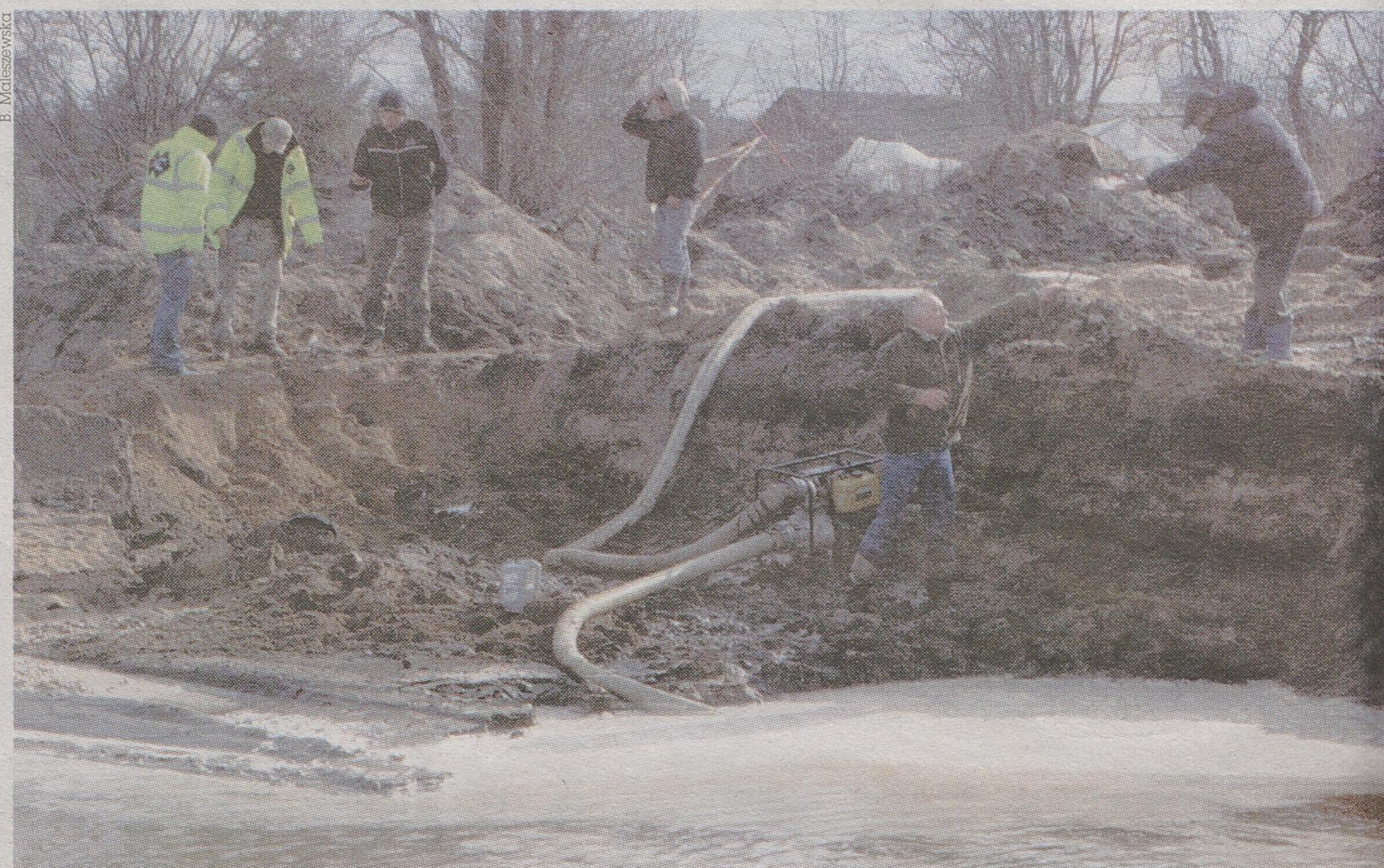
W miejscu awarii utworzyło się niewielkie jezioro. Po usunięciu wody przez robotników wykonujących roboty ziemne, do łatania dziury przystąpią pracownicy Wodociągów Białostockich.
