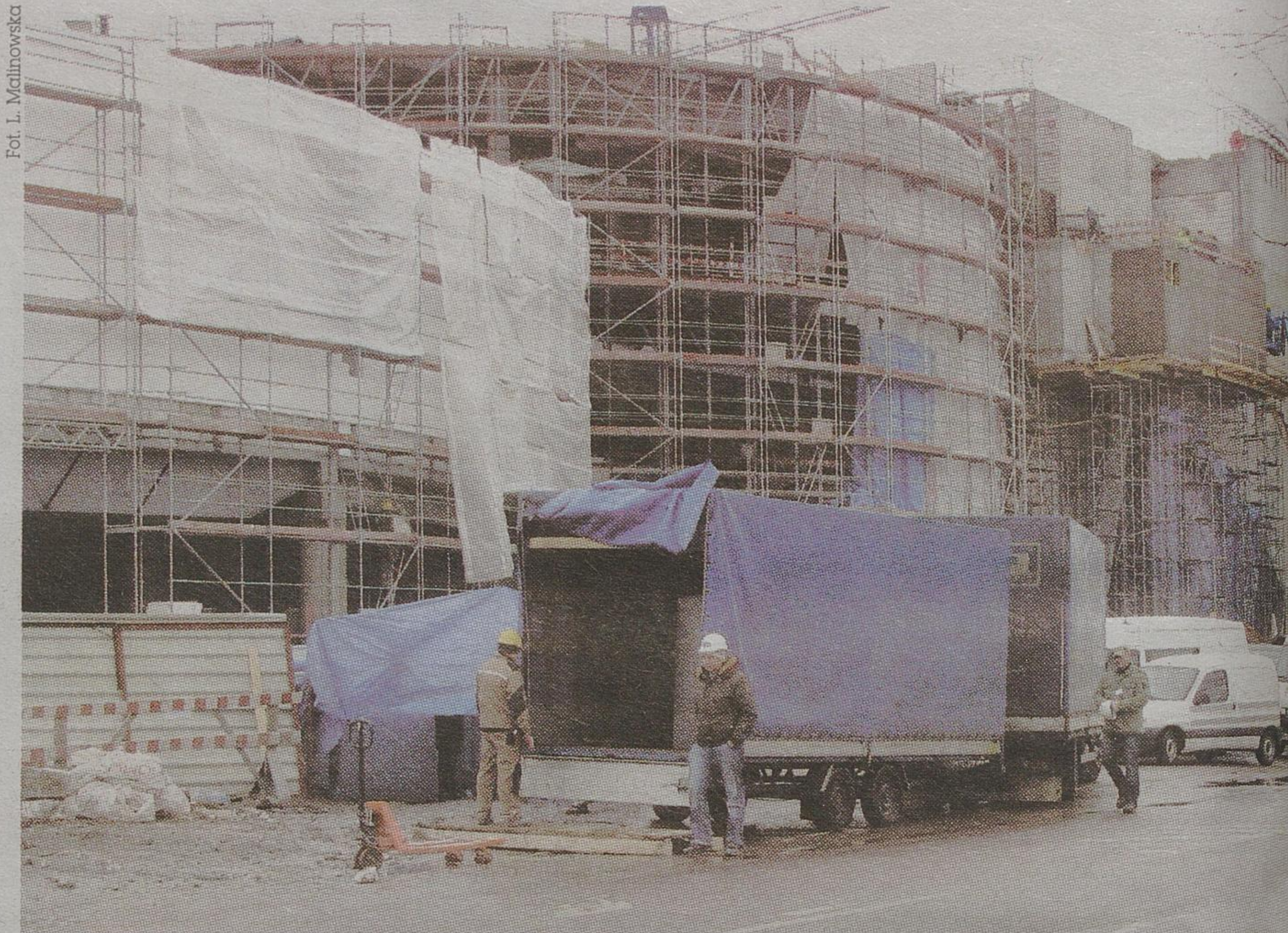
Suwałczanie obawiają się, że obiekt podzieli losy tego, który Plaza budowała w Lublinie. Tam, po krótkim okresie, trzeba było go zamknąć i poddać remontowi.
