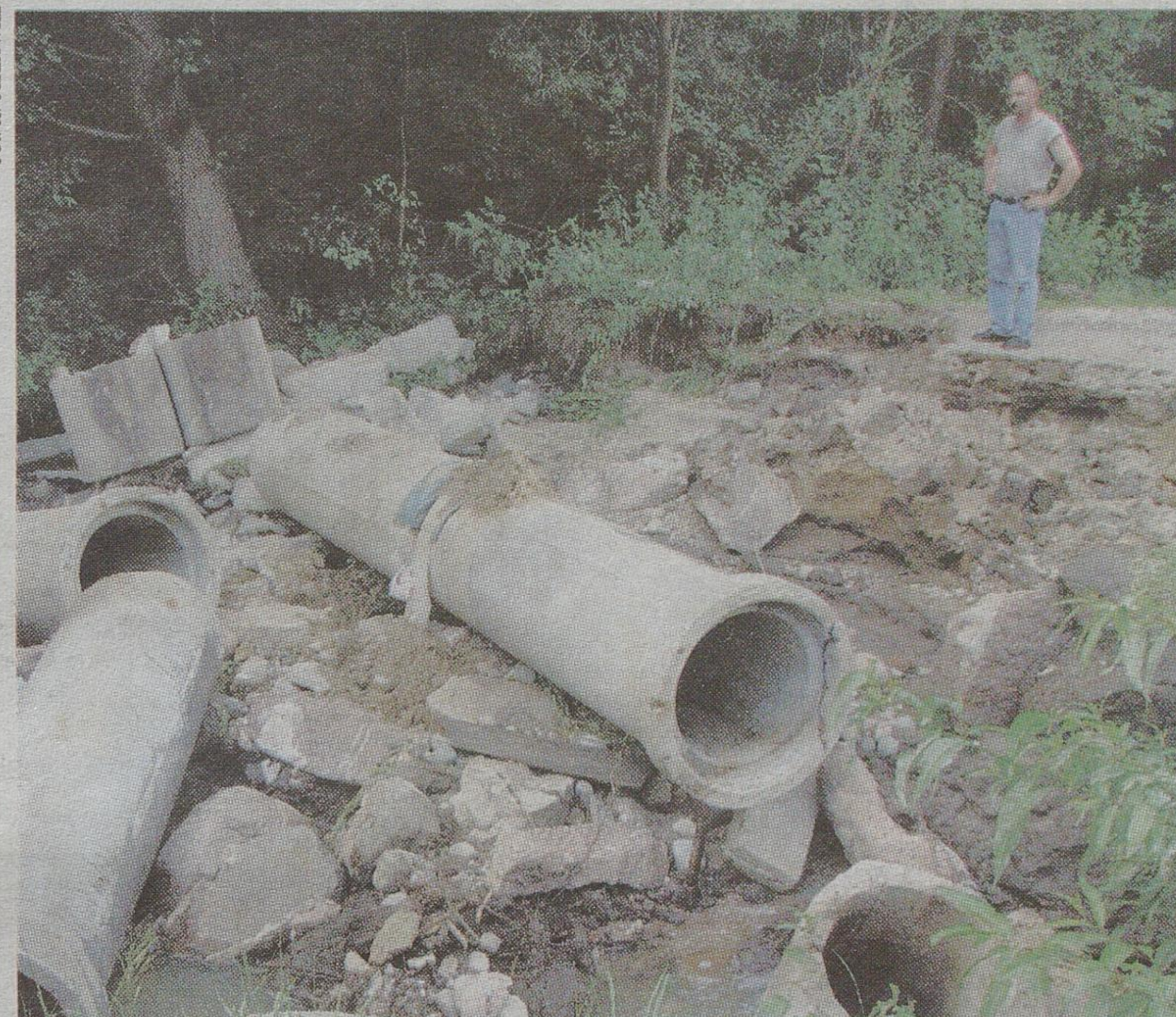
– Woda przelewała się przez drogę do Antonowa i w końcu przerwała przepust – mówi Mirosław Bałło
