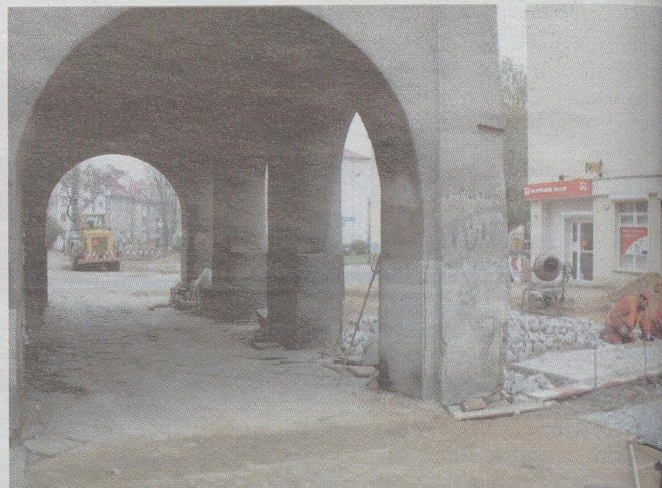
Ten zrujnowany chodnik znajduje się koło placu miejskiego, pod kamienicą Białówny 3. Miasto nie ma chęci go remontować.
