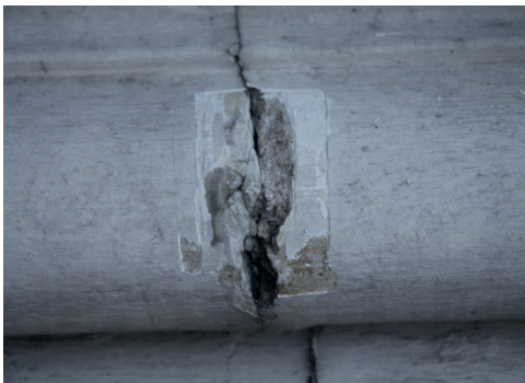
3 e. Pod warstwą malatury wtórnej widoczne resztki oryginalnej warstwy malarskiej w kolorze ugrowym (żółcień) oraz oryginalny tynk w kolorze szarym. Na tej odkrywce wyraźnie widać, że były dwie warstwy wtórne malatur: wierzchnia warstwa w kolorze écru oraz warstwa pod nią w kolorze szarym Under the secondary paint layer, remnants of the original paint layer in yellow (ochre) and the original grey plaster are visible. This test pit clearly shows two secondary paint layers: the outer layer in ecru and a layer beneath it in grey
