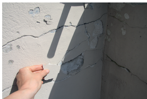
5 c. Odkrywka nr 4. Zbliżenie. Pod warstwą malatury wtórnej widoczne resztki oryginalnej warstwy malarskiej w kolorze niebieskim (błękit) oraz oryginalny tynk w kolorze szarym
