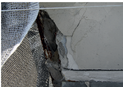
6 c. Miejsce odkrywki naturalnej. Zbliżenie. Pod warstwą malatury wtórnej widoczne resztki oryginalnej warstwy malarskiej w kolorze niebieskim (błękit) oraz oryginalny tynk w kolorze szarym Location of the natural test pit - close-up. Under the secondary paint layer, remnants of the original paint layer in blue (azure) and the original grey plaster are visible
