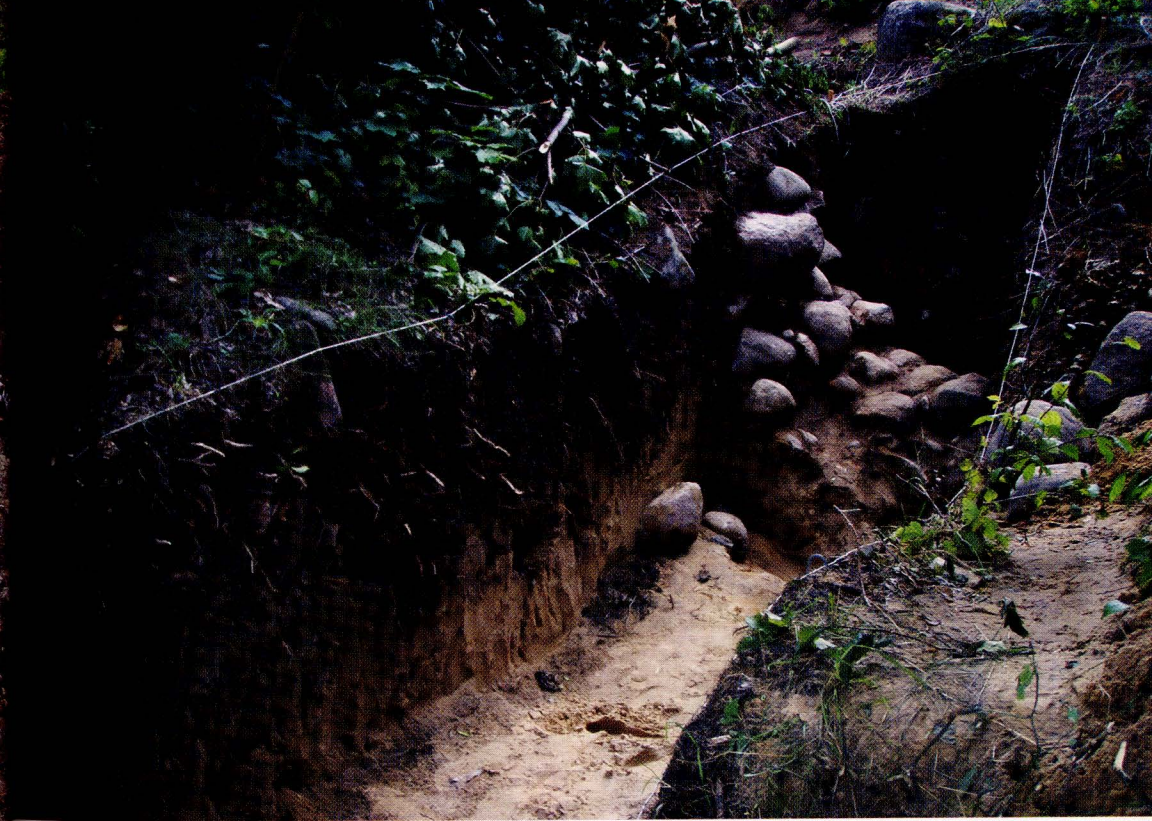
Fot. 15. Obiekt 2, wykop 14/2006, mocno zniszczony fundament ściany wschodniej budynku
