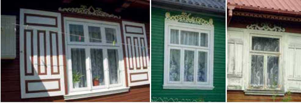
Fot. 3.12. Zdobnictwo okien: 1-2) wieś Plutycze, gm. Bielsk Podlaski, 3) wieś Kojły, gm. Czyże; fot. autor i archiwum WAPB
