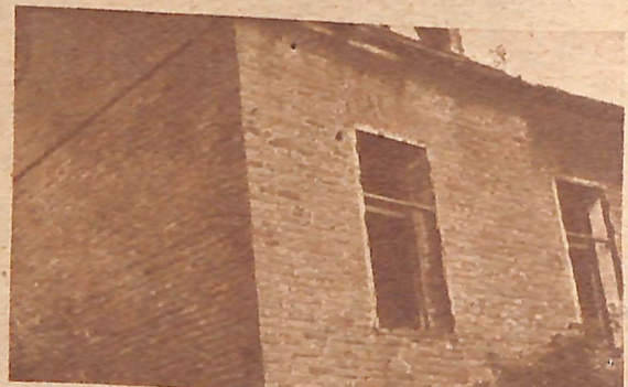
Oto niszczący budynek szkolny we wsi Wróblki Szlacheckie.
