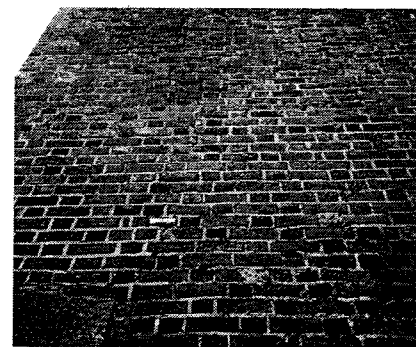
Rys.5. Spęknięcia murów na elewacji północnej
