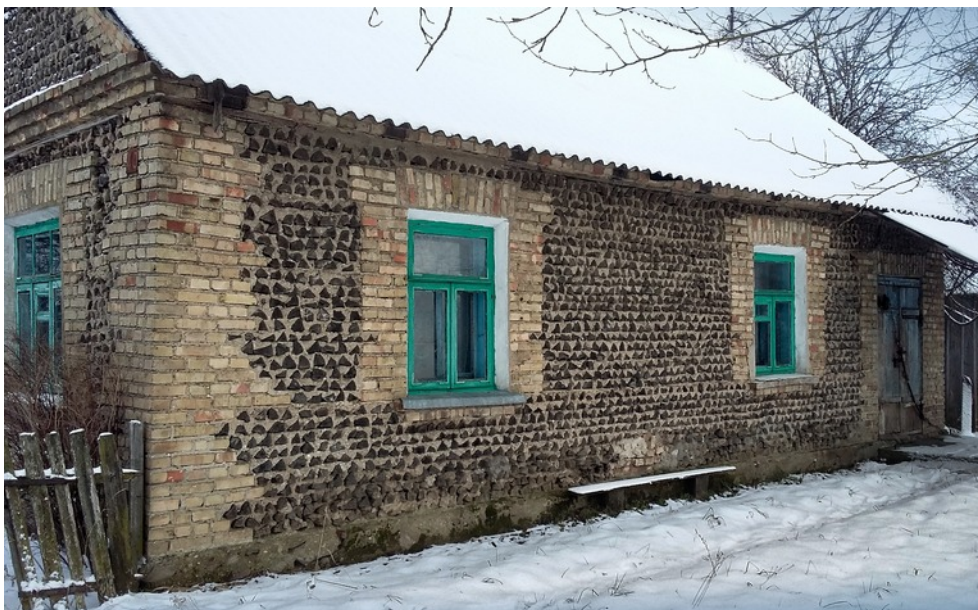
Ryc. 58. Dom w białoruskiej wsi Strubnica mający zasadę konstrukcyjną podobną jak w budynkach stawianych według zaleceń Hundta, w tym ceglane zabezpieczenia naroży, zaś ściany z drewna spajanego zaprawą; fot. Julia Mazets, 2016 (z archiwum Wydziału Architektury Politechniki Białostockiej)
