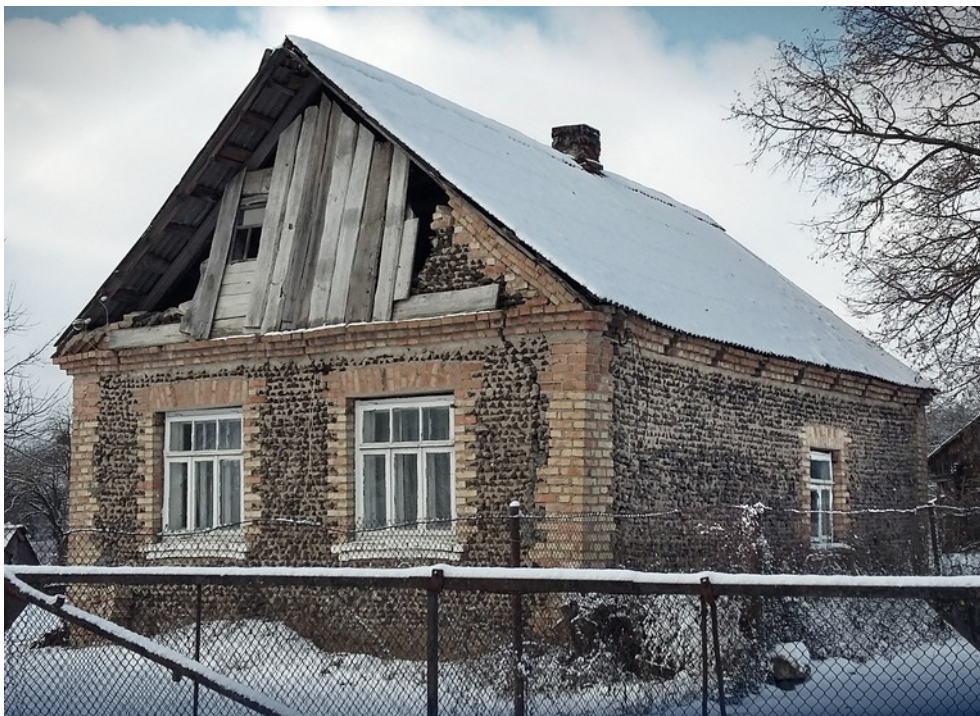
Ryc. 59. Dom w białoruskiej wsi Strubnica mający zasadę konstrukcyjną podobną jak w budynkach stawianych dawniej według zaleceń Hundta; fot. Julia Mazets, 2016 (z archiwum WA PB)
