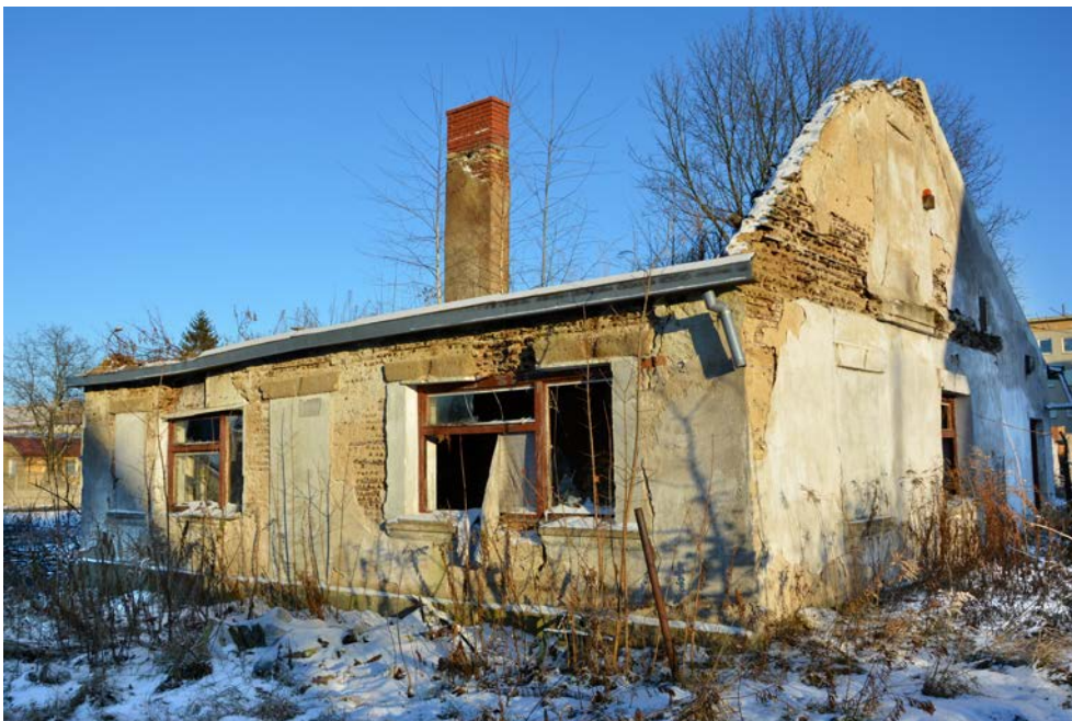
Ryc. 6. Pochodzący z lat trzydziestych XX wieku budynek drewnobetonowy w Białymstoku przy ul. Trawiastej 2, wyburzony pod koniec 2016 roku; fot. autor, grudzień 2016
