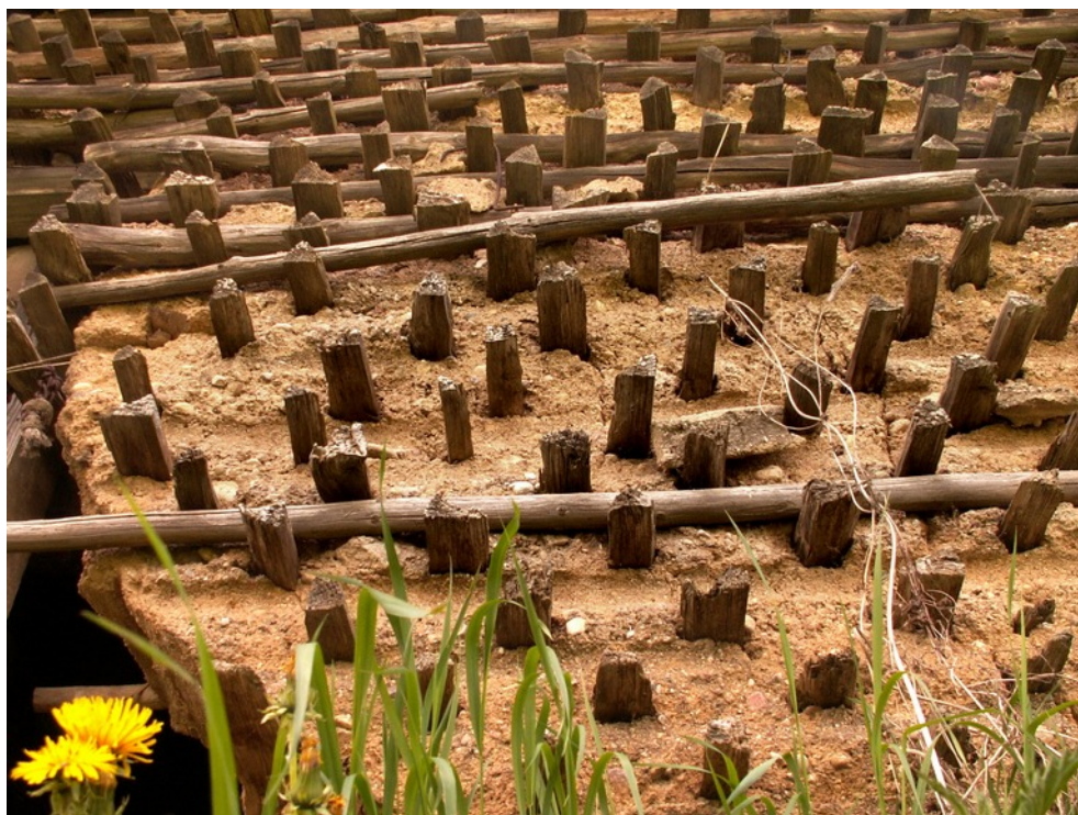
Ryc. 51. Ściana glinobita zbrojona polanami i drewnianymi prętami (wieś Gliniszcz Wielkie w gminie Sokółka na Białostocczyźnie); fot. autor, 2009
