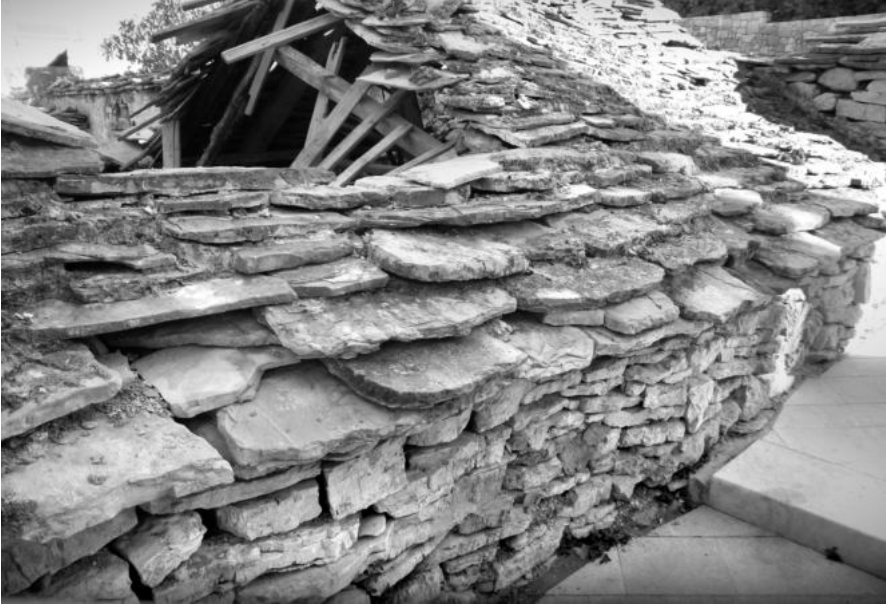
Ryc. 17. Zniszczony dach ardezowy w chorwackim Szybeniku (fot. autor, 2013)
