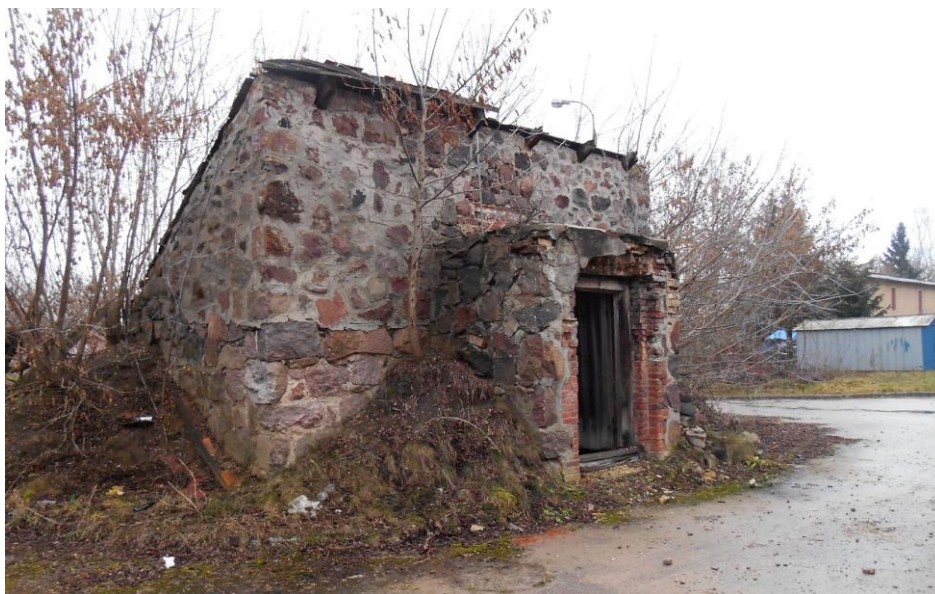
Kolejowa kamienno-ceglana piwnica wybudowana przed I wojną światową, przy końcu ul. Zamkowej. Taka piwnica ze stacji w Lewkach, w dokumentacji WKZ, datowana jest na lata 80. XIX w. Podobna znajduje się także koło dworca w Kleszczelach. Fot. Janusz Porycki 11 I 2020 r.
