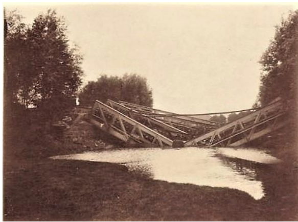
Zniszczony most kolejowy na rzece Białej w Bielsku
