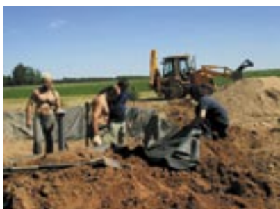
Budowa przydomowej oczyszczalni ścieków, przy wkładzie pracy własnej i pomocy sąsiadów, wcale nie jest taka kosztowna. Wysilek szybko się zwróci!
