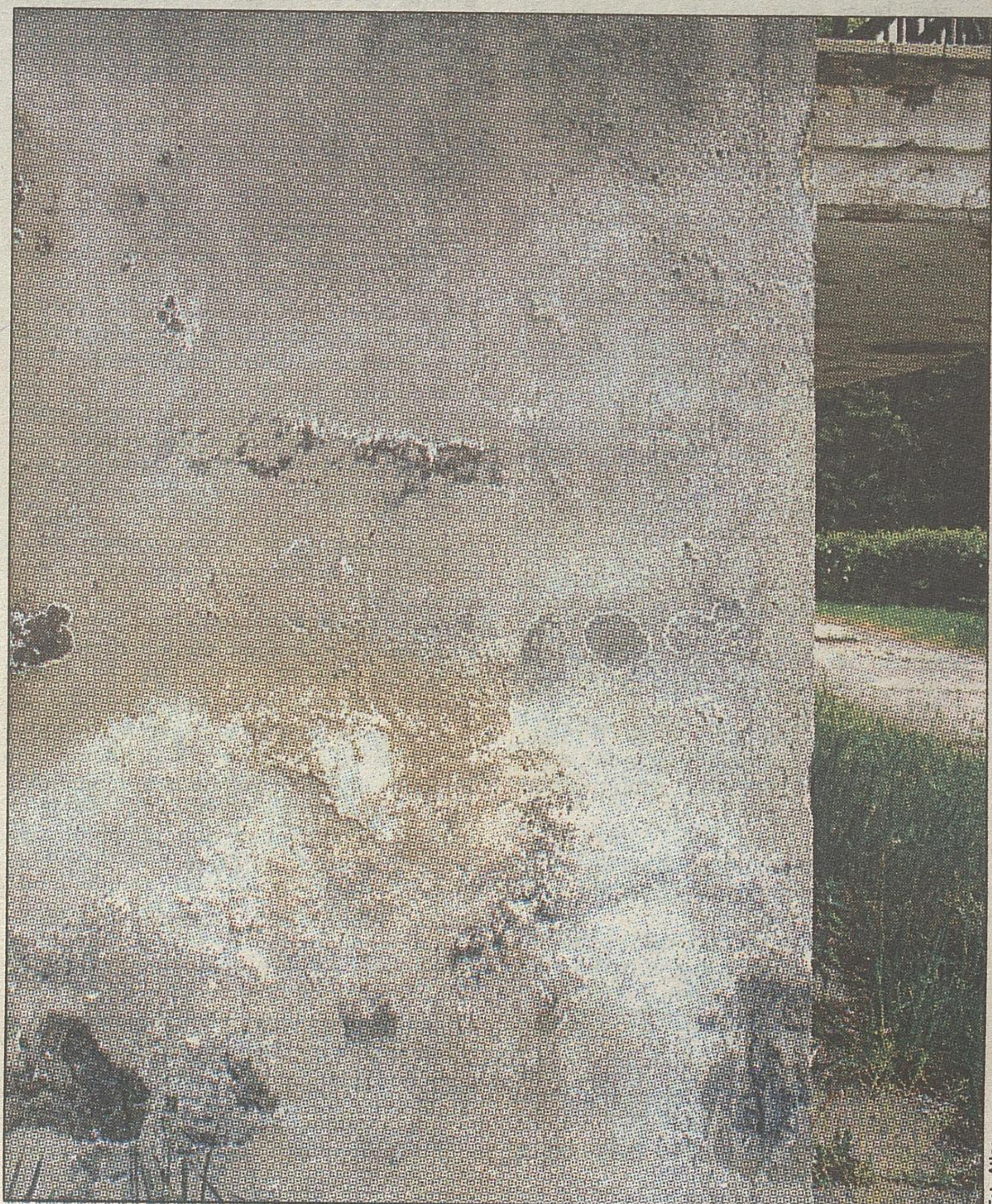
Grzyby na elewacji to poważny problem w wielu budynkach
