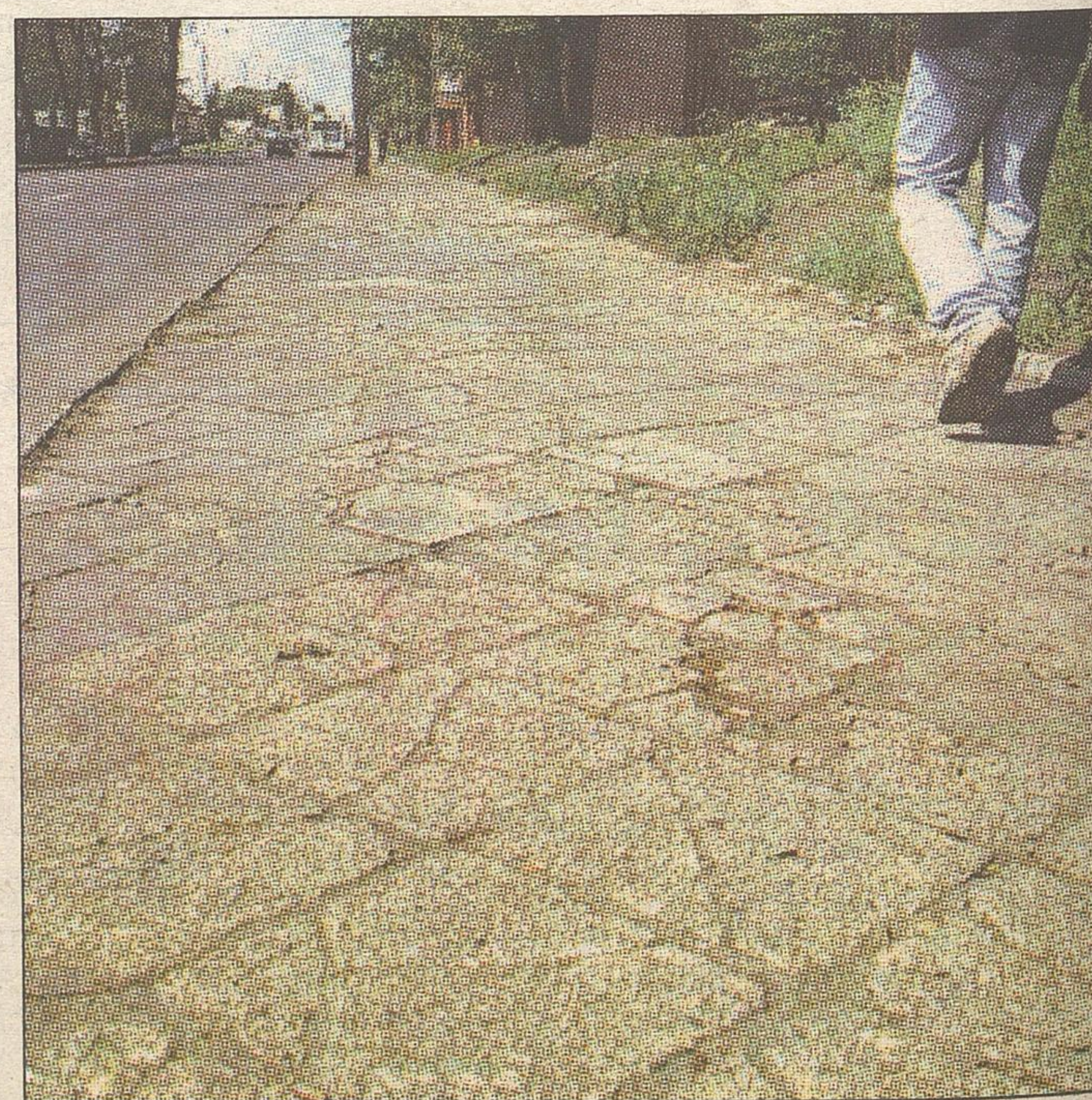
Na takim chodniku można wykręcić nogę. ZDM obiecuje jego remont jeszcze wiosną.
