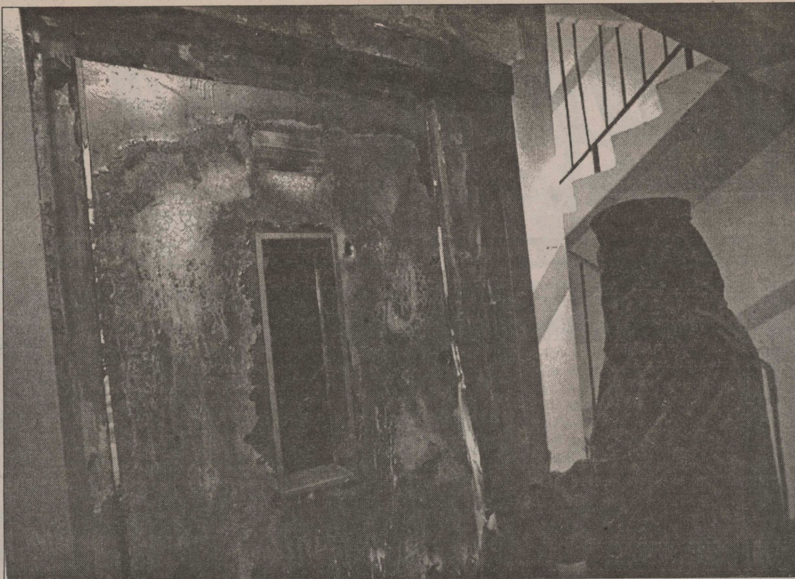
Zniszczona winda w wieżowcu przy ul. Towarowej będzie nieczynna do połowy kwietnia
