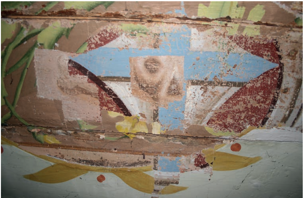
5. Turośl. Kościół pw. św. Jana Chrzciciela. Prace konserwatorskie przy polichromii stropu, centralnie widoczna najstarsza polichromia z lat siedemdziesiątych XIX w., 2016. Fot. M. Andron Turośl. Church of St. John the Baptist. Conservation of ceiling polychrome, in the centre: the oldest polychrome from the 1870s, 2016. Photo: M. Andron
