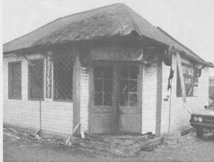
Spalony kiosk na bazarze przy ul. Sejneńskiej.
