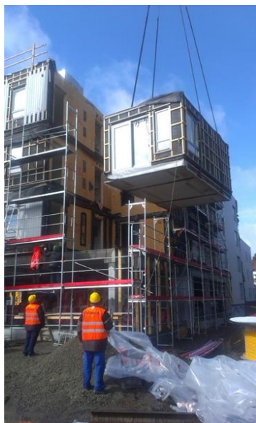
Rys. 4. Budynki drewniane modułowe (Źródło: Unihouse): a) w technologii szkieletu drewnianego, b) w trakcie budowy
