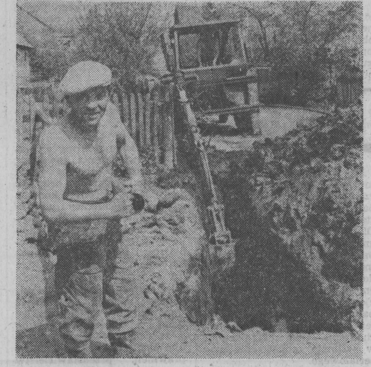
Brigadzista ZBIGNIEW BARTNICKI i operator koparki — WIESŁAW GRABOWSKI zakładają wodociąg we wsi Płonka — Strumińska.
