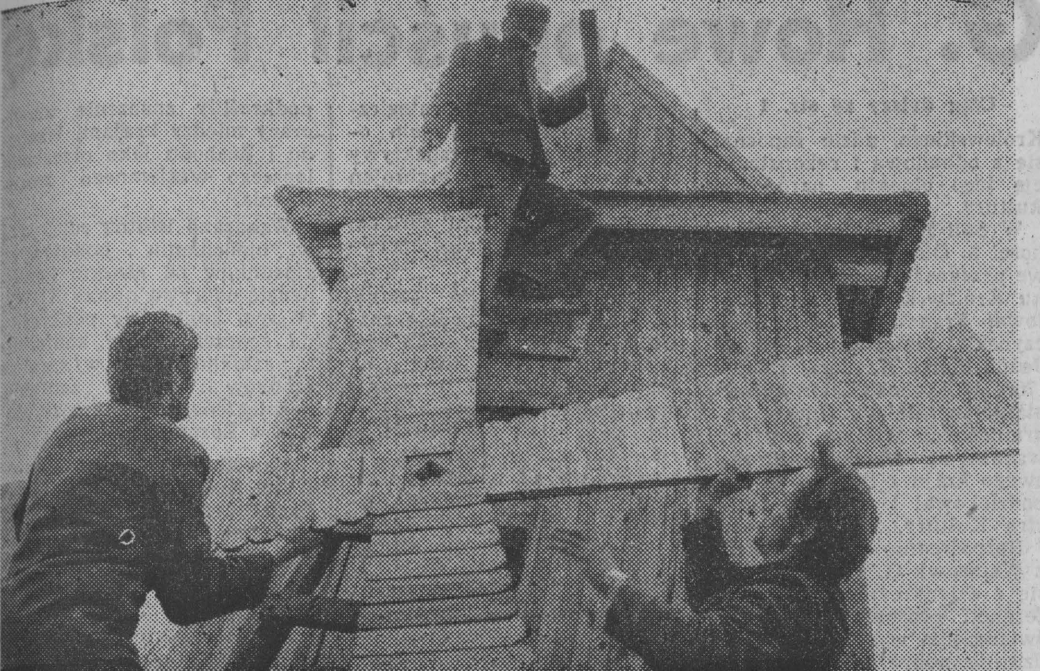
W stylizowanym wiatraczku znajduje się punkt gastronomiczny. Przy pracach montażowych EDMUND URBAN, PIOTR WRÓBLEWSKI i LESZEK KOŚCIUKIEWICZ. Fot. K. SWIDERSKI
