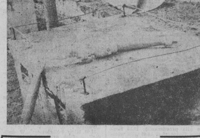
Uszkodzeniu uległa tylko niewielka część dachu i tynki w magazynach.
