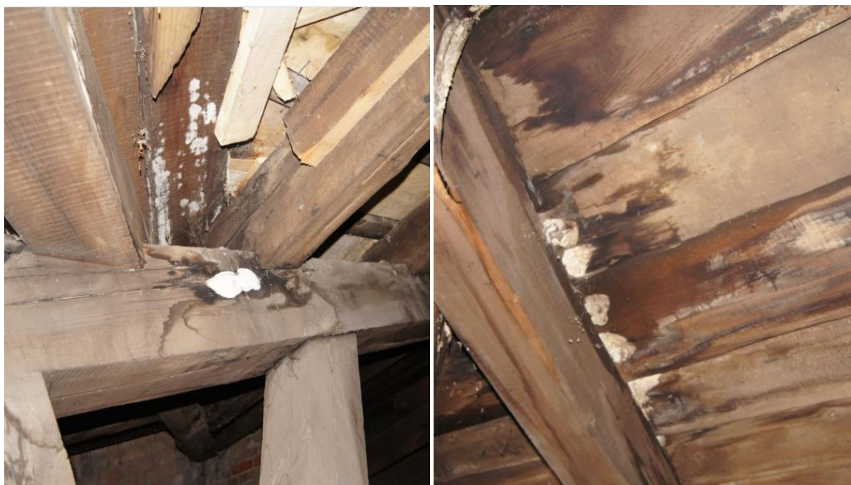
Rys. 4. Widoczne miejsca występowania grzybów domowych w konstrukcji dachu
