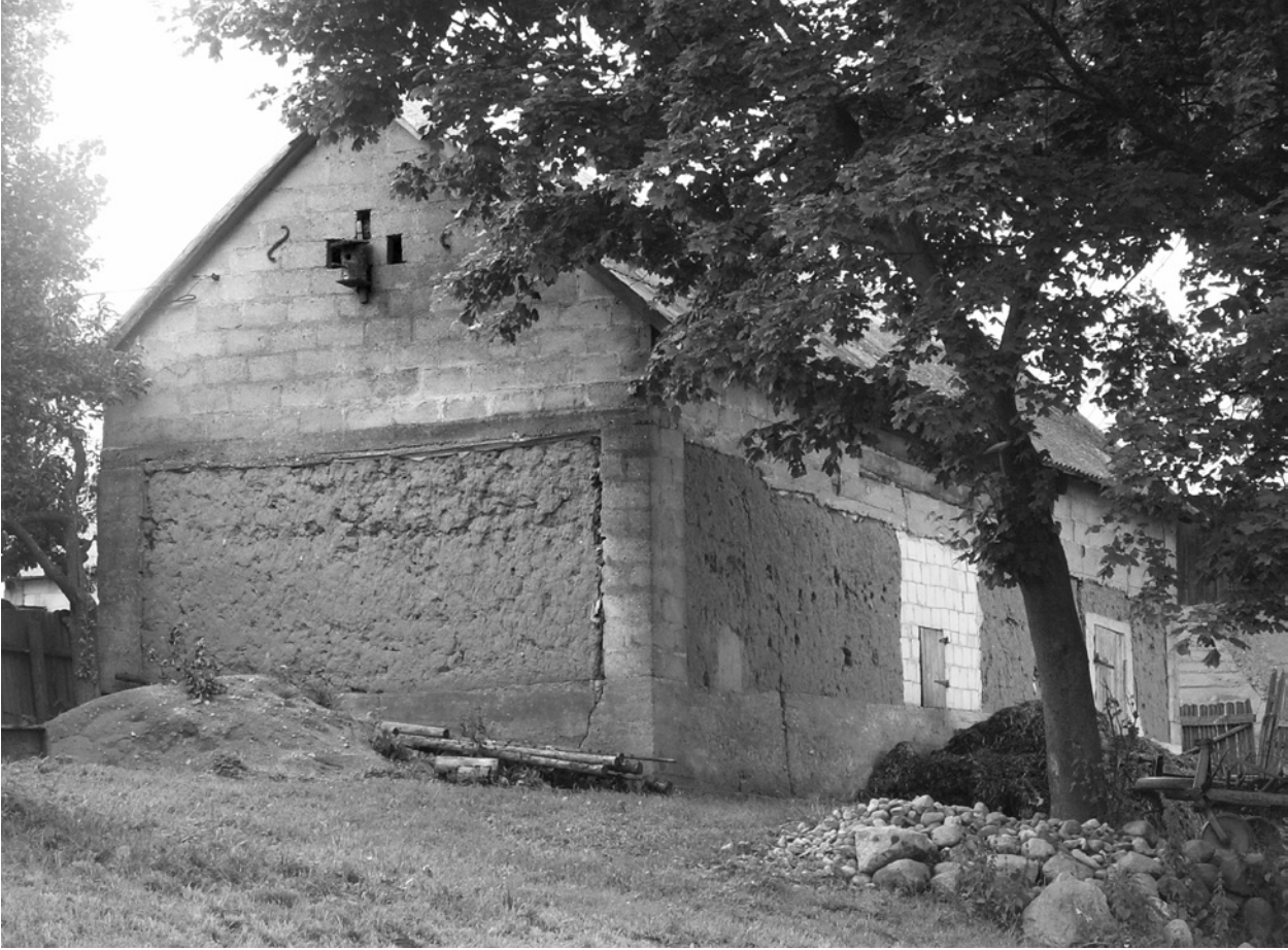
Ryc. 5. Budynek gospodarczy we wsi Wygorzel w gminie Szypliszki; fot. J. Szewczyk, 2008 Fig. 5. A barn in Wygorzel in Szypliszki commune; photo by J. Szewczyk, 2008
