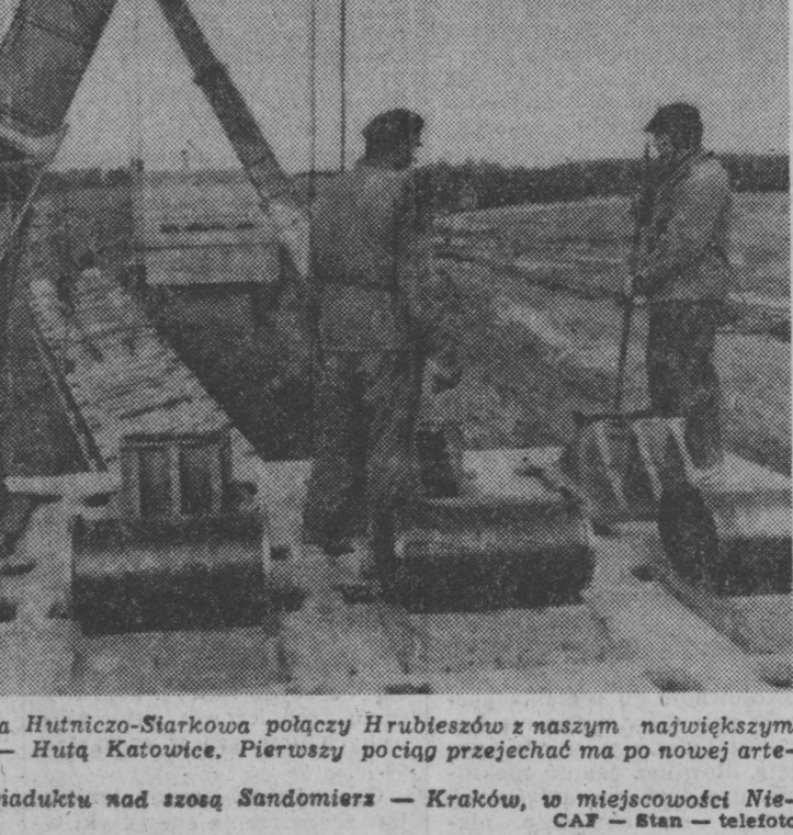
NA BUDOWIE LHS. Linia Hutniczo-Startkowa połaczy Hrubieszów z naszym największym obiektem metalurgicznym — Hutą Katowice. Pierwszy pociąg przejechał na nową arterię jeszcze w tym roku.
