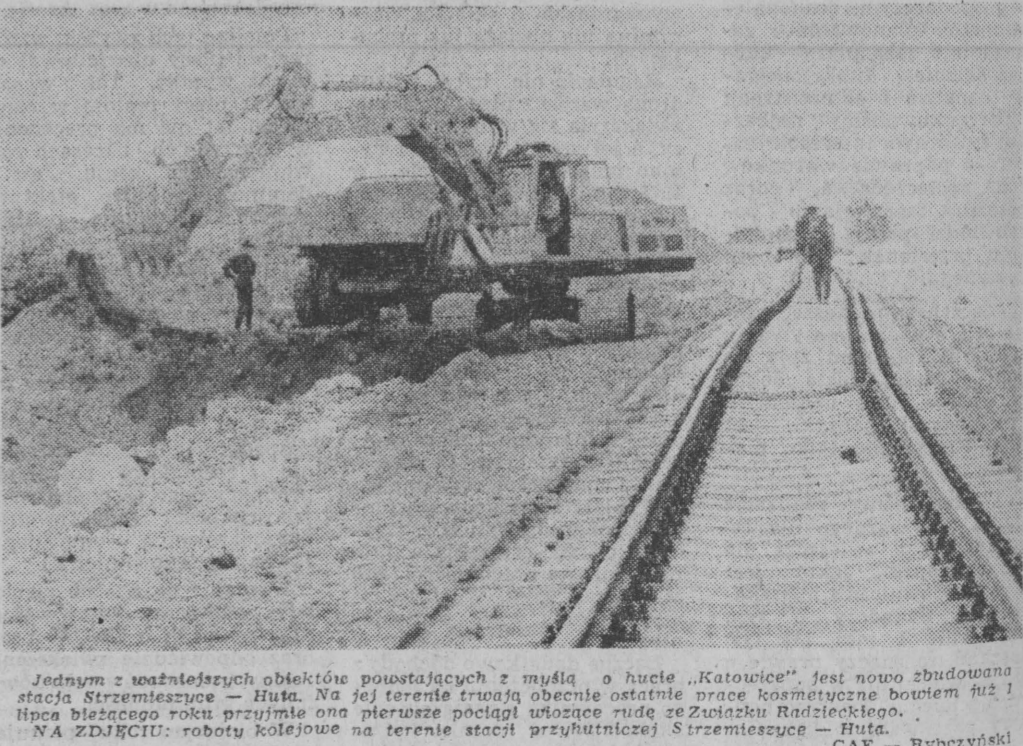
Jednym z ważniejszych obiektów powstających z myślą o hucie „Katowice”, jest nowo zbudowana stacja Strzemieszko — Huta. Na jej terenie trwały obecnie ostatnie prace kosmetyczne budownictwa. Na zdjęciu: roboty kolejowe na terenie stacji przyłiniowej Strzemieszko — Huta. CAF — Rybnicki
