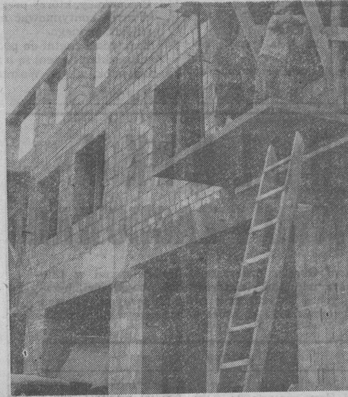
Trwają prace przy budynku mieszkalnym. Jego parter zajmą sklepy i placówki usługowe.
