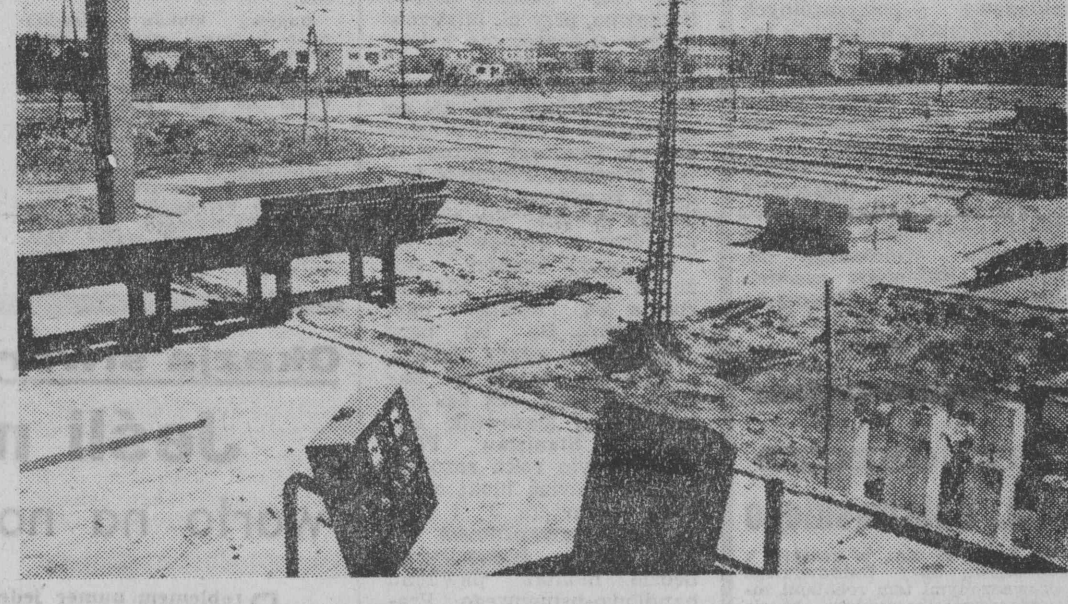
Brak płyt osłonowych do hall traktów. Jak na dźwini widać jest obrznięty plac składu surowca.
