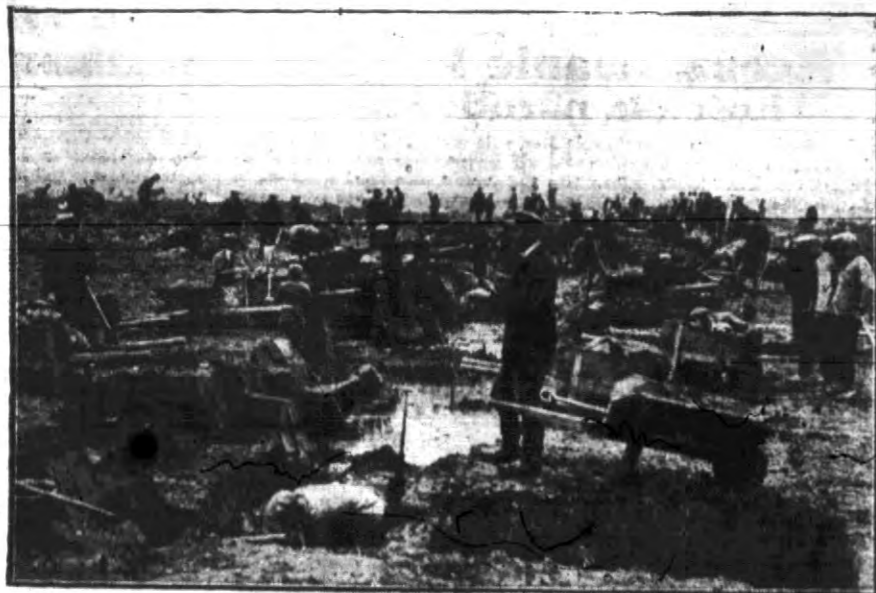
na Saskiej Kopie, która ma być terenem wystawowym, rozpoczęto zakrojone na wielką skalę roboty odwodniające. Zdjęcie nasze przedstawia kopanie wielkiego kanału odwodniającego. Roboty te dosięgły już Czerwonej Drogi przy parku Paderewskiego
