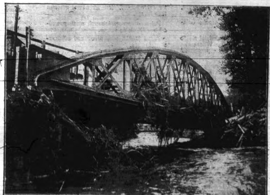
Jaka miała miejsce w niemieckich Górach Odrznych, wezbrane wody rzek opadły, odkrywając obraz niebywałego zniszczenia.
