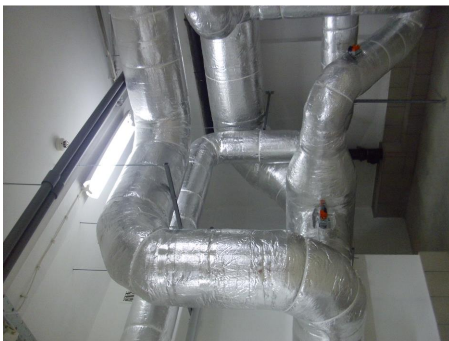
Rys. 3. Przewody wentylacyjne (fotografia – zbiory własne)
